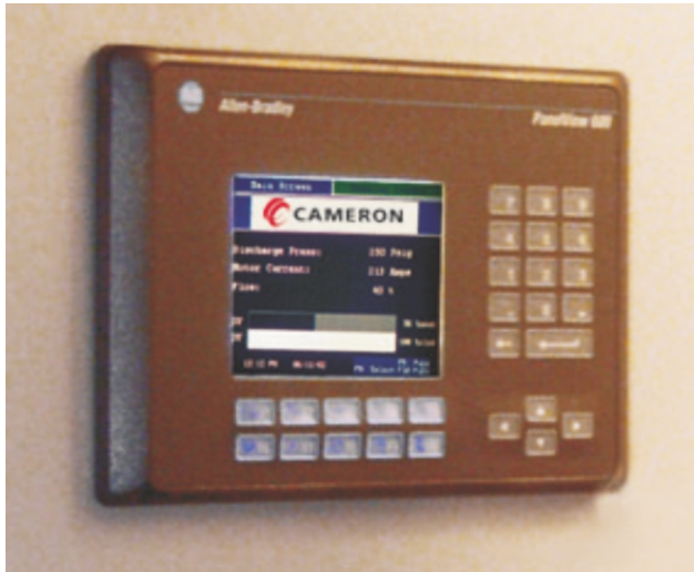
Центр управления на базе ПЛК Allen Bradley с интерфейсом PanelView
