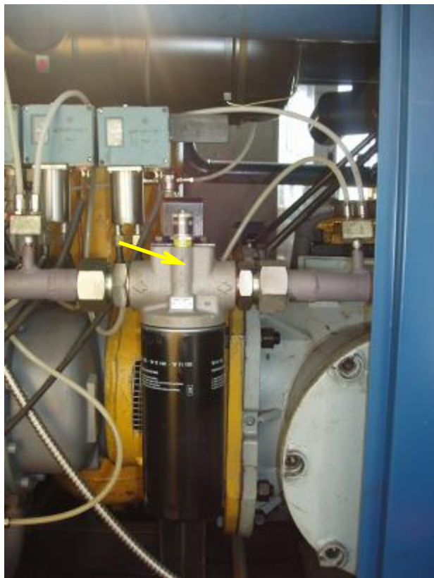
7. Визуальный контроль перепада давления масла на масляном фильтре и перепада давления на фильтре-сепараторе
